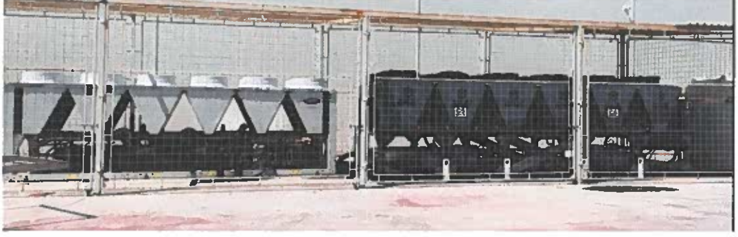
Chiller Soğutma Grubu
