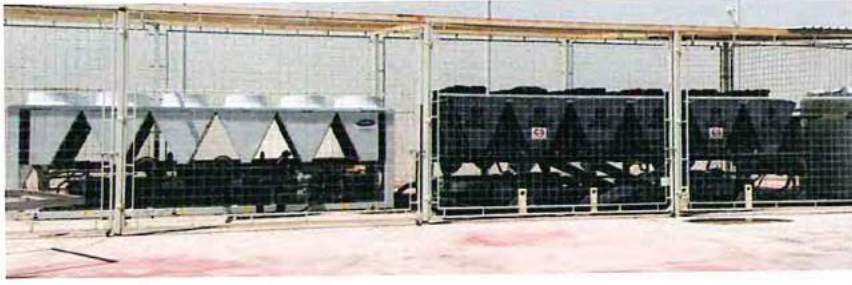
Chiller Soğutma Grubu
